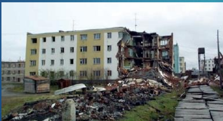
Неравномерное оседание и разрушение угла дома, в связи с таянием вечной мерзлоты. Черского, Сибирь. (Фото: В. Романовский).
